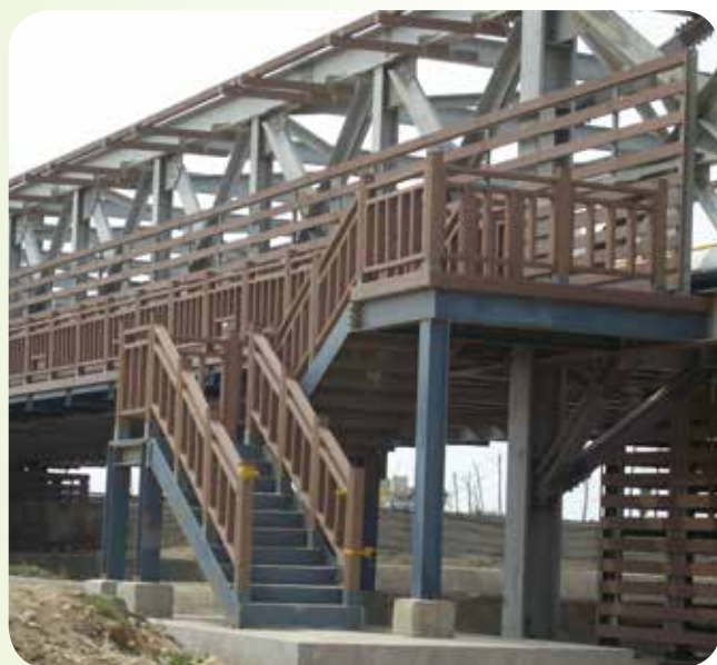
台塑桃園工業園區管橋工程
